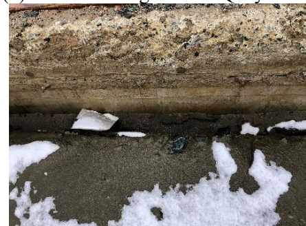
(d) Close up of the crack in (c)
