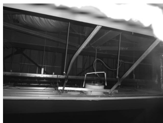
(d) Buckling of braces
