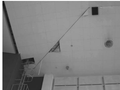
(d) Failure of ceiling panels
