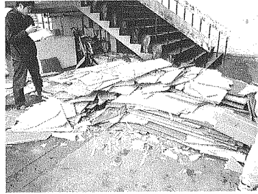
(d) Piled up fallen ceiling members
